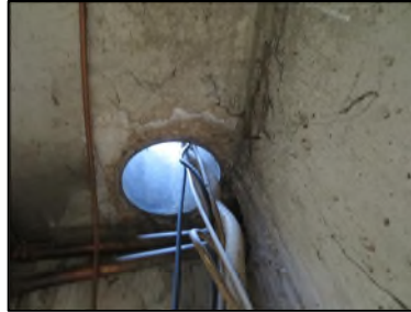
Photo N° 598 AMIANTE CIMENT -- GAINE TECHNIQUE 4 Conduits de fluide Ventilation haute (Fibres- ciment)
